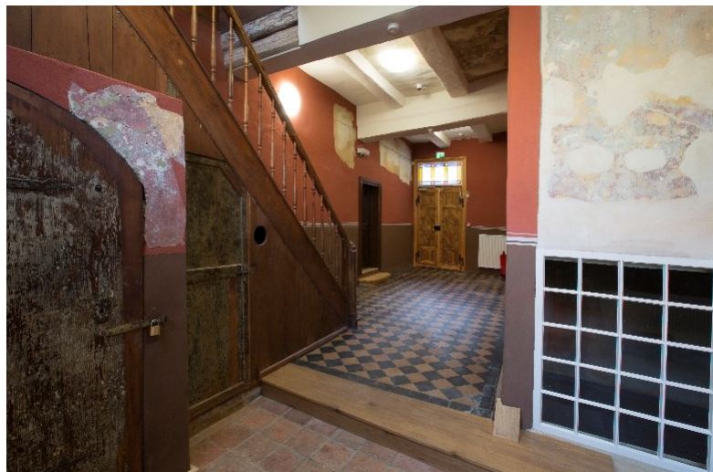
Blick in den Eingangsbereich des Fachwerkgebäudes am Schlossberg 11, Foto: Kulturstiftung Sachsen-Anhalt, Christoph Jann
